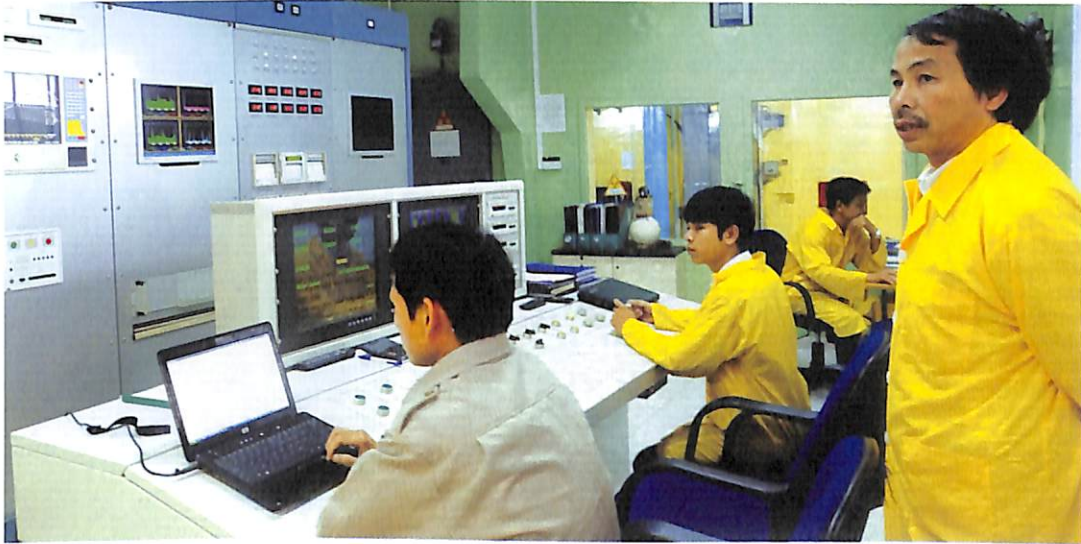
Ê kíp vận hành lò phản ứng nghiên cứu tại Viện Nghiên cứu hạt nhân Đà Lạt
