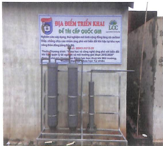
Hình 3. Hệ thống xử lý khí sinh học.
