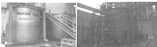
Hình 5. Khu vực bể chứa và bể khuấy
