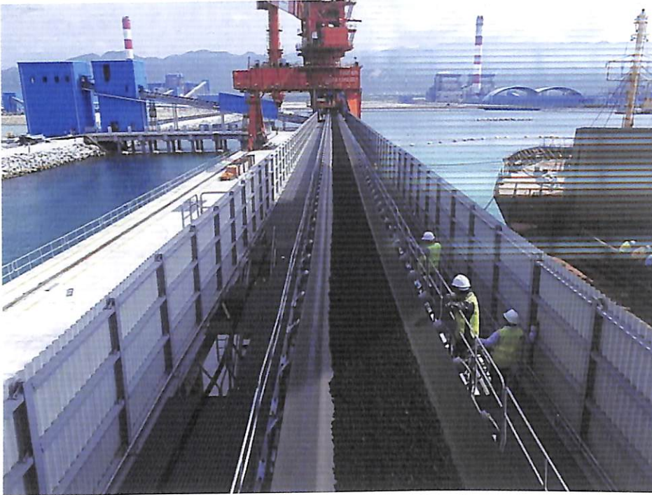
Hệ thống bốc dỡ và vận chuyển than tại nhà máy nhiệt điện.
