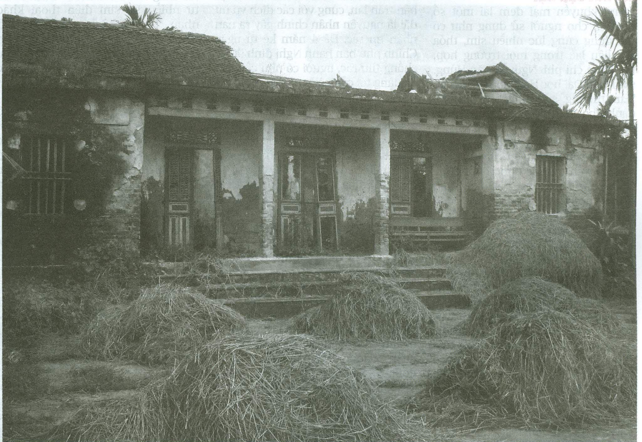
Nhà văn hóa thôn Bạch Xá Trại (xã Nam Hưng, Tiên Lãng) trong tình trạng xập xệ không sử dụng được.
